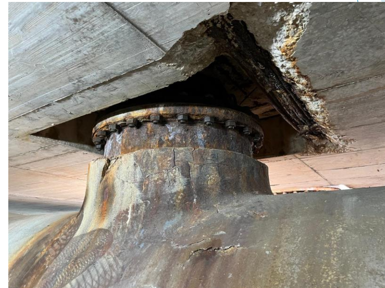
Problemas de corrosión
